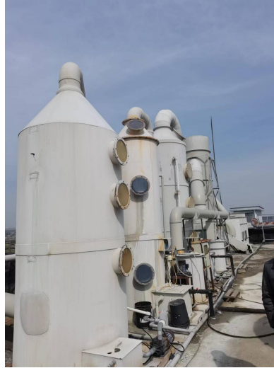
图 4-3 企业现有喷淋塔现场实景图
