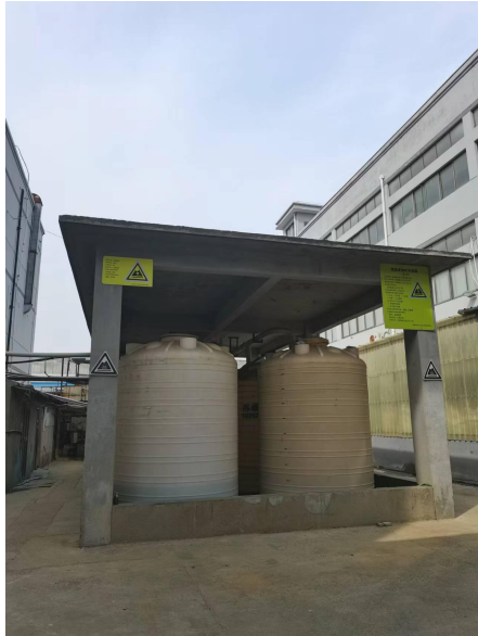
企业现有储罐区实景照片
